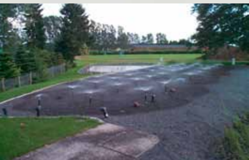
Neptunfilter: eine der Wasseraufbereitungskomponenten in Kirchdorf
