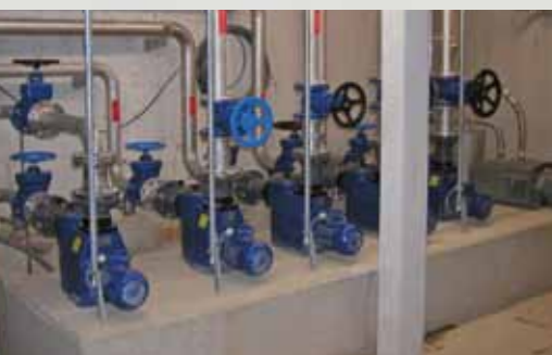
Technikkeller mit Pumpen
