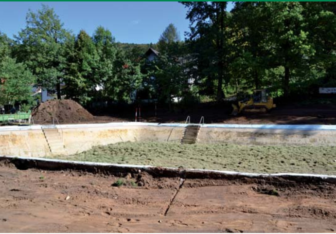
Anfang September sind bereits die Bagger angerückt und haben mit den Erdarbeiten für die Umgestaltung des Weißenbrunner Naturbades begonnen
